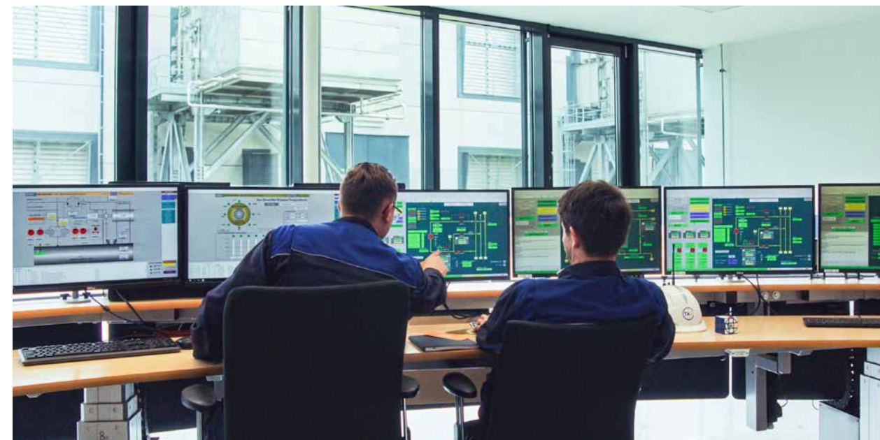
Kontrollraum in der Kompressorstation Weitendorf.
